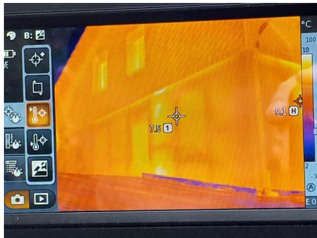
Abbildung 16: Wärmebilduntersuchung an einem Gebäude in der Gemeinde Radibor
